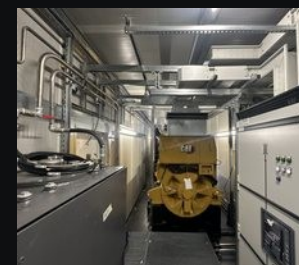
Électricité tertiaire et armoires
