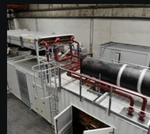
Aéroréfrigérant en toiture
