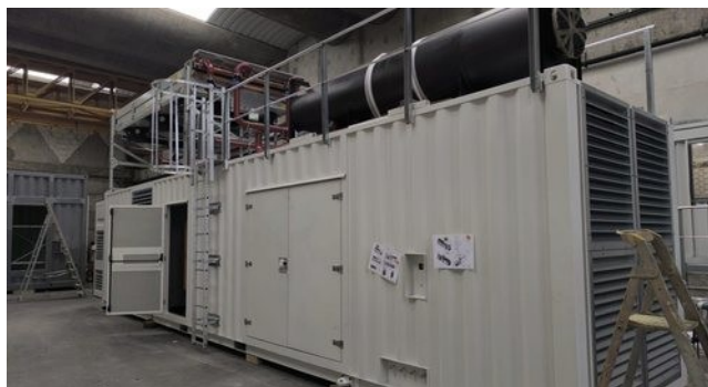
GE refroidi par aéroréfrigérant en toiture, site industriel en Afrique
